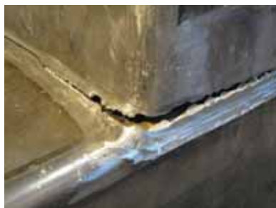
(j) T-1.00-34: weld rupture
