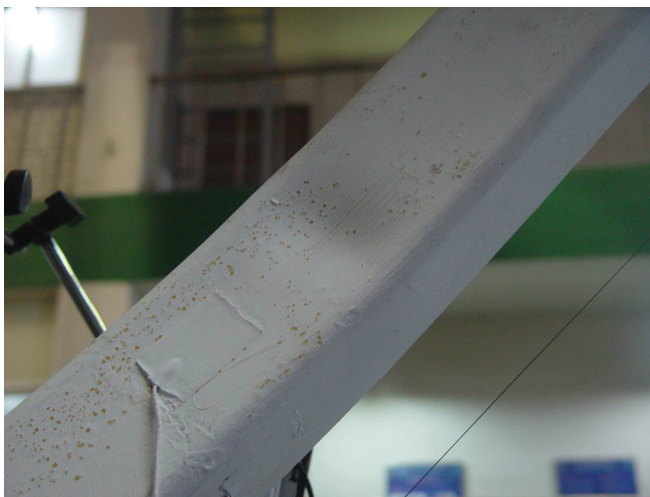
(c) Local buckling ( -2\% ).
